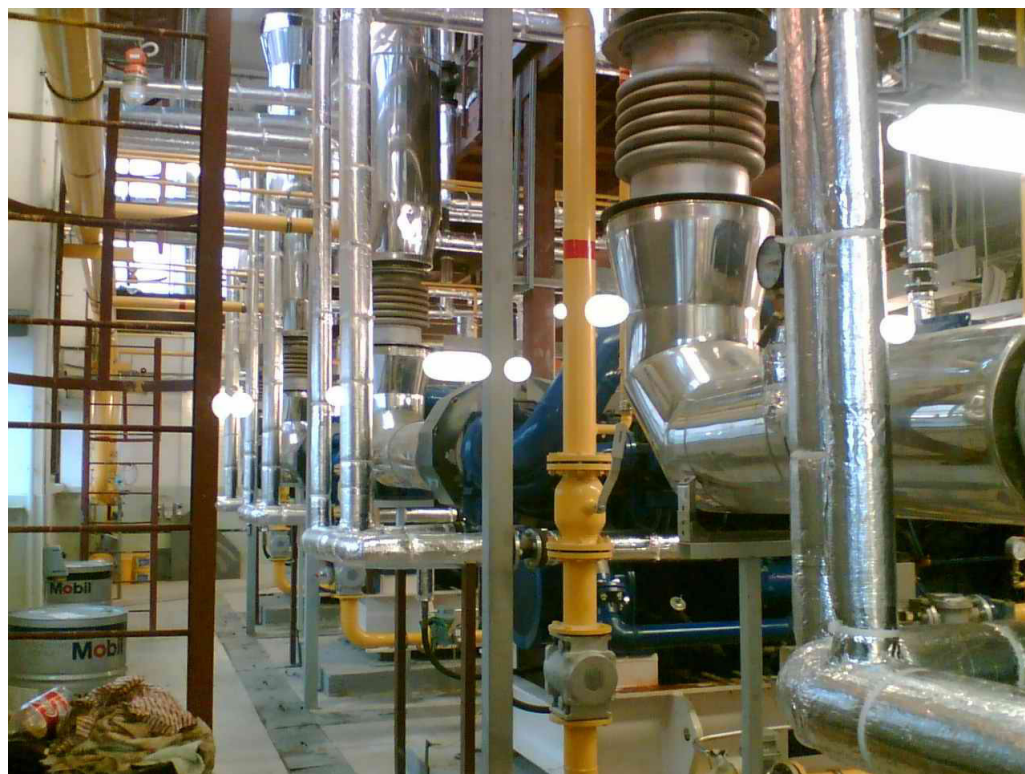
Мини-ТЭС ТК «О'Кей» на Московском проспекте, 12,5 МВт тепловой нагрузки. Проектирование ОВ, ТМ, АУ и Д Мини-ТЭС, монтаж «под ключ» технологического и вспомогательного оборудования, временная эксплуатация.
